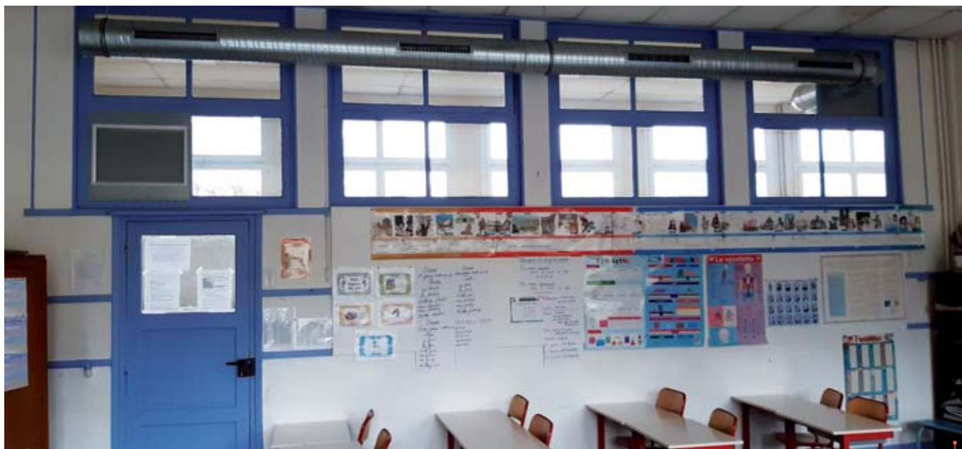
Centrale de traitement d'air double flux semi-centralisée, école élémentaire La Fontaine (Le Raincy), classe n°3 - © Jade Lachery
