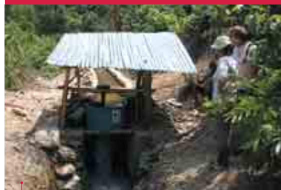
1,000W pico hydro turbine Source: Électriciens sans frontières
