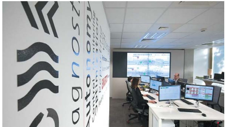
Hubgrade, centre de monitoring intelligent à Paris, lancé en 2016
