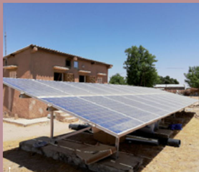
Site de la mini-centrale de Kéré, exploitée par SALENSOL
