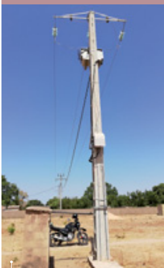
Point de jonction entre le réseau moyenne-tension de Sénélec et le réseau basse-tension exploité par NSRESIF, village de Diaglè.
