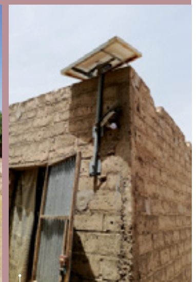
SHS installé chez un ménage dans le village de Darou Djaji Guéyène, exploité par NSRESIF
