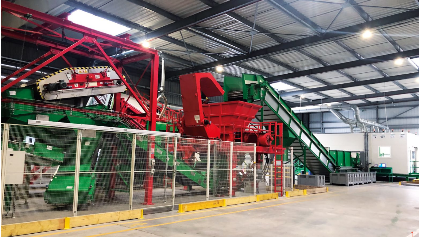
Ligne de traitement PAM Portet sur Garonne.
