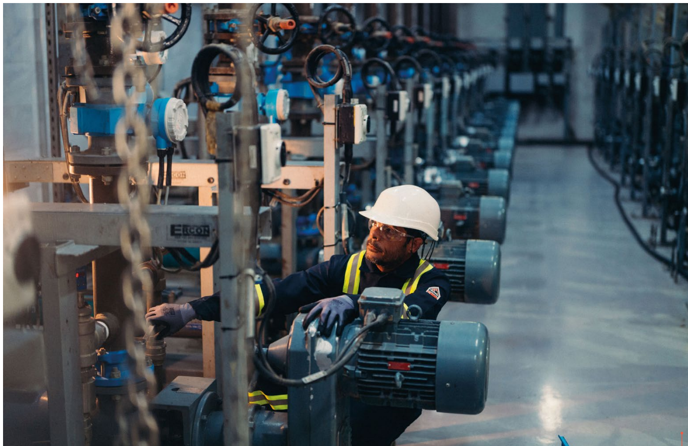
Unité de traitement des eaux usées, Jordanie. Ce site traite les eaux usées de la capitale et des alentours et les redistribue. Il couvre 25 % des besoins en irrigation du pays et 12 % de l'ensemble des besoins en eau (à usage domestique en particulier).
